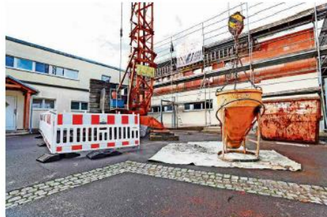
Am Kindergarten „Ruppbergspatzen“ wird aufgestockt und modernisiert, auch mit Photovoltaikmodulen. Die Dächer des Mittel- und Osttraktes werden wegen Schäden neu abgedichtet.
